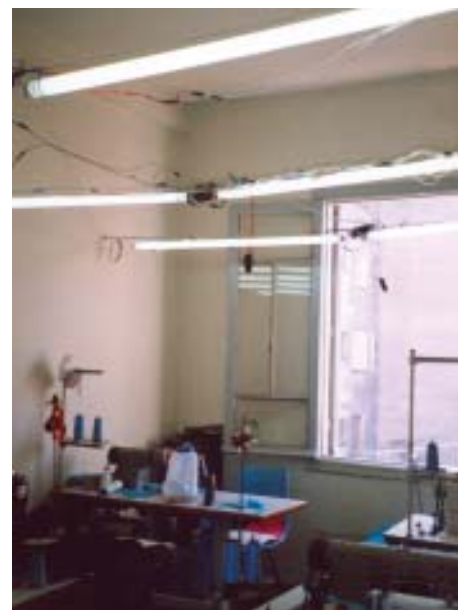
Com a fiação elétrica exposta, o risco de incêndio é permanente
